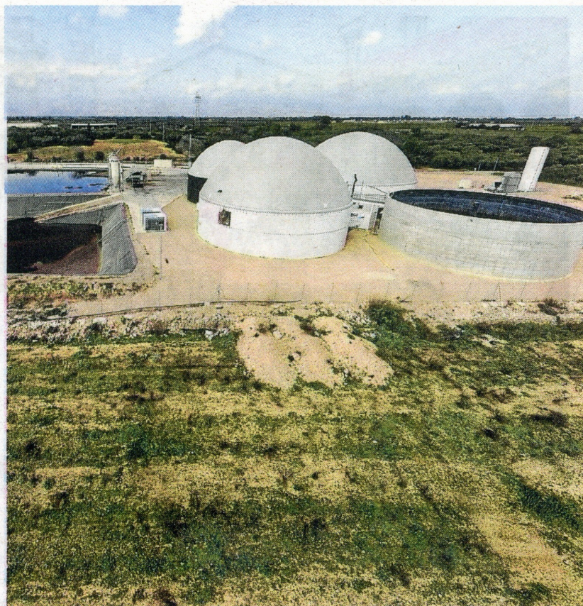
Instal·lacions de Biometagás La Galea SL. FOTO: JOAN REVILLAS
