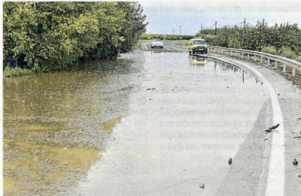
Detall del punt d'inundació en aquesta via en un dels darrers aiguats. FOTO: J. REVILLAS
