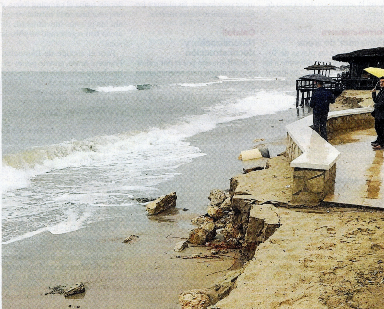
Roda de Berà será uno de los municipios que recibirá arena este mes para reponer los daños. FOTO: DT
