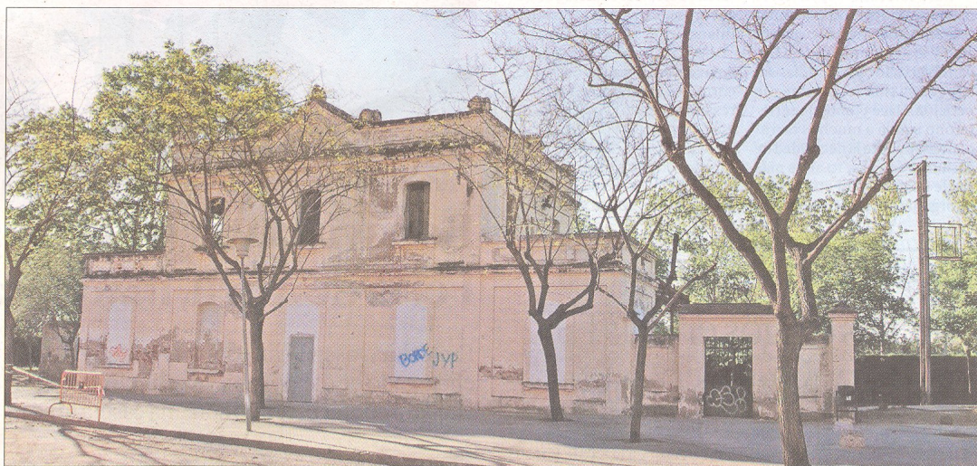
Aspecto de degradación que ofrecía ayer la estación de El Morell. FOTO: LLUÍS MILIÁN
