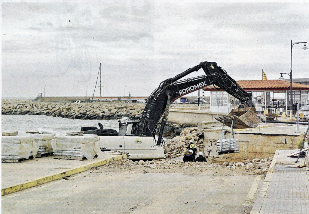
El Departament de Territori va reparar l'esvoranc format a la façana marítima de les Cases d'Alcanar la tardor passada. FOTO: JOAN REVILLAS
