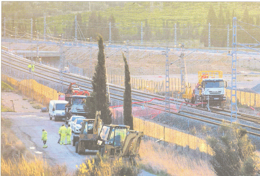
Aquest és el punt del recorregut ferroviari que es va desviar i que ara tornarà al seu traçat original. FOTO: JOAN REVILLAS
