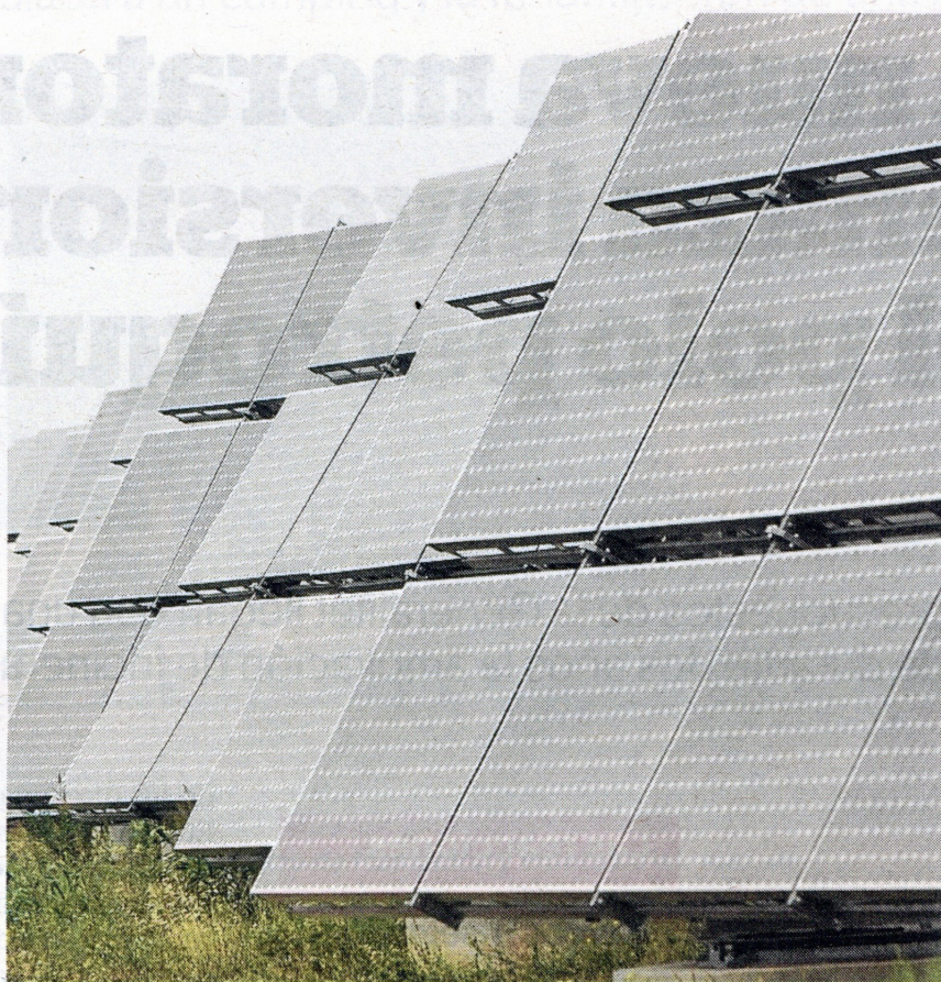
Una planta solar fotovoltaica. FOTO:JOAN REVILLAS
