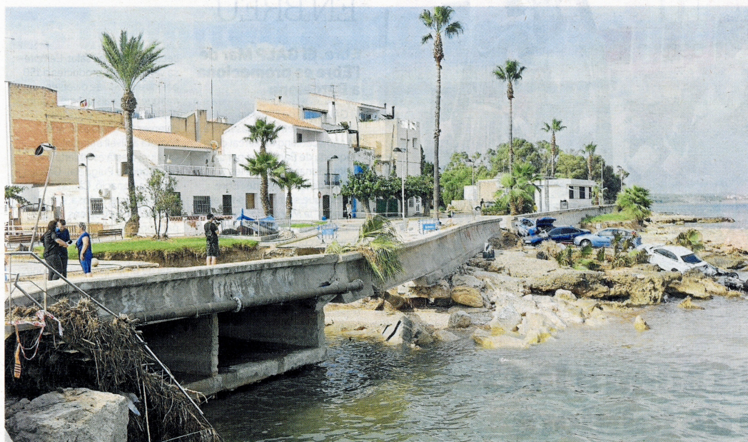
Detall de l'esvoranc obert al nord de la façana marítima des les Cases, on encara hi ha vehicles a la mar, ahir. FOTO: JOAN REVILLAS
