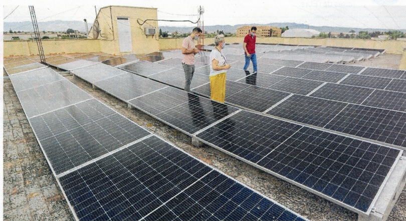
Plaques instal·lades al sostre de l'ajuntament de Deltebre. FOTO:JOAN REVILLAS
