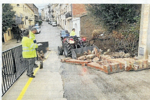
També Paülis es va aixecar ahir amb tots els carrers plens de fang, camins afectats i dos murs caiguts. FOTO: CEDIDA
