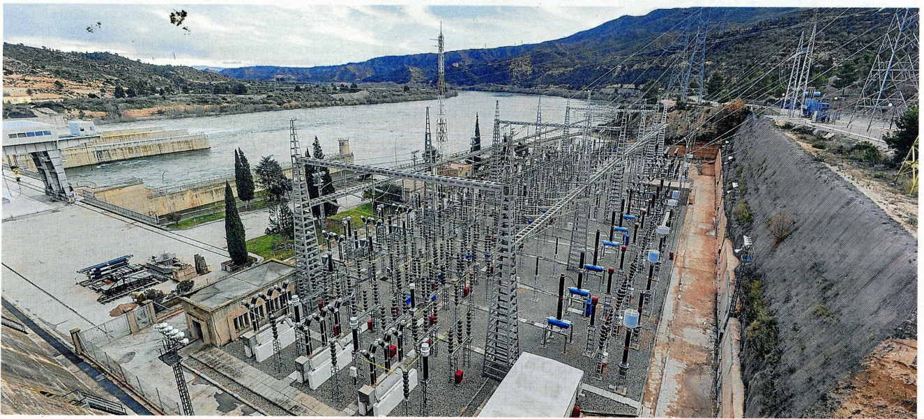
Imatge de l'actual central hidroelèctrica al pantà de Riba-roja d'Ebre, a la Ribera d'Ebre. FOTO: JOAN REVILLAS
