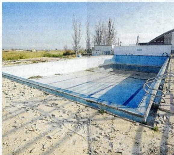
Estat actual de l'antiga piscina descoberta, que va tancar les portes fa 18 anys. FOTO: JOAN REVILLAS
