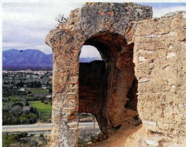
Imatge d'un detall del fortí, visiblement degradat.
