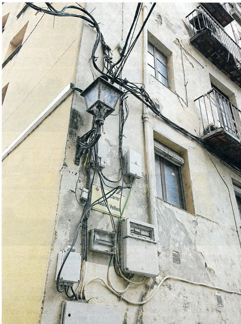
Diferents comptadors de llum, la majoria obsolets, però encara a les façanes. FOTO: JON REVILLAS.
