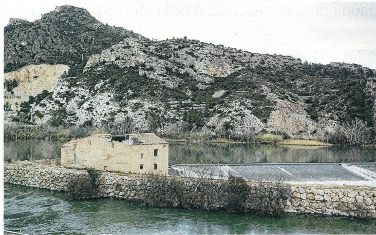
L'edifici està molt deteriorat, i té part de la teulada enfonsada. FOTO: JOAN REVILLAS
