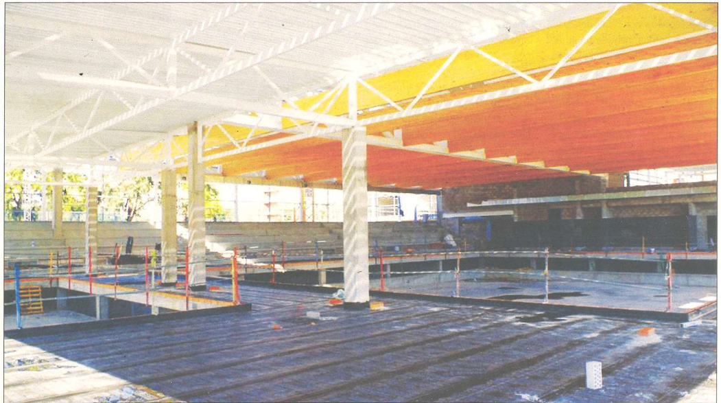
El complex esportiu de la nova piscina de Tortosa, en una imatge d'esta setmana, està a la recta final de les obres i serà un dels equipaments dels jocs.
