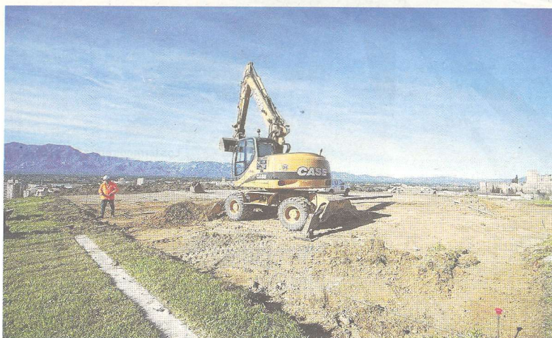
Obres de remodelació de l'heliport al Verge de la Cinta. FOTO: JOAN REVILLAS
