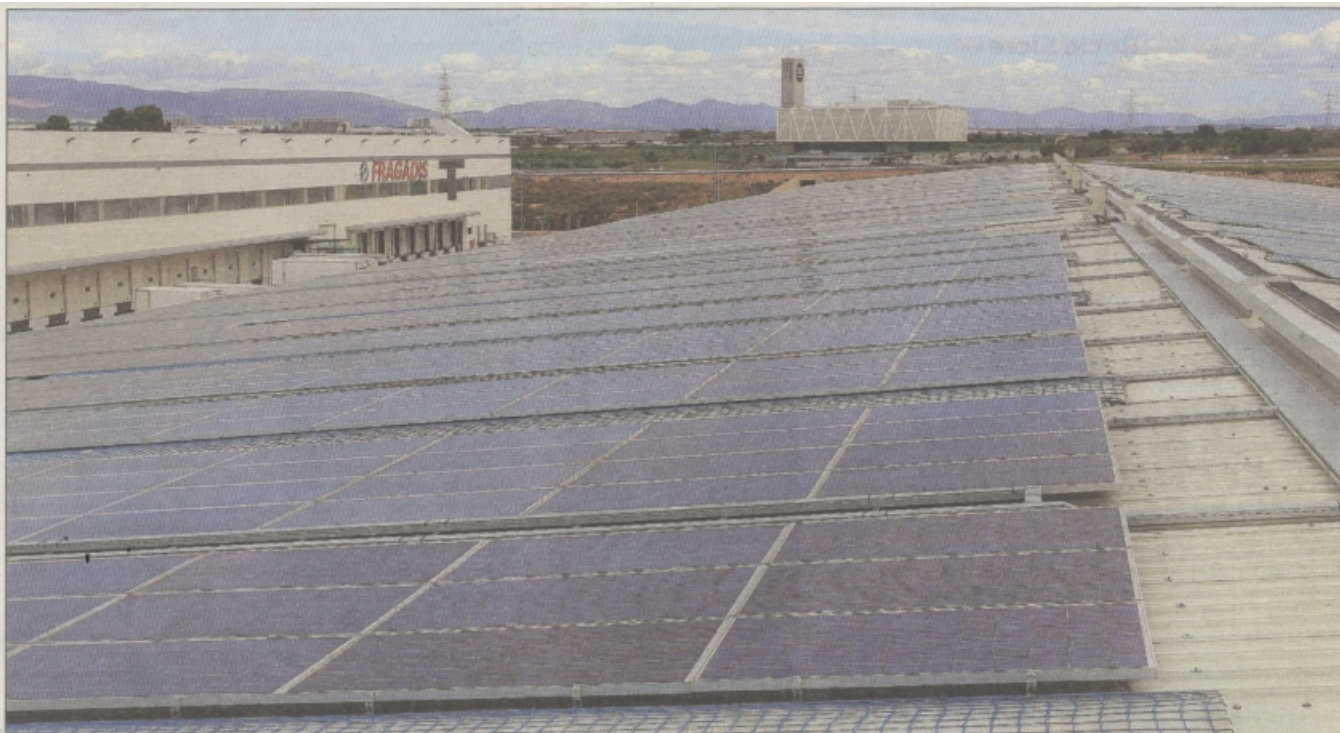
La plataforma fotovoltaica en el CIM del Camp, inaugurada hace unos días, suministrará 1,2 megavatios, lo que equivale al consumo anual de 416 familias. FOTO: PERE FERRÉ
