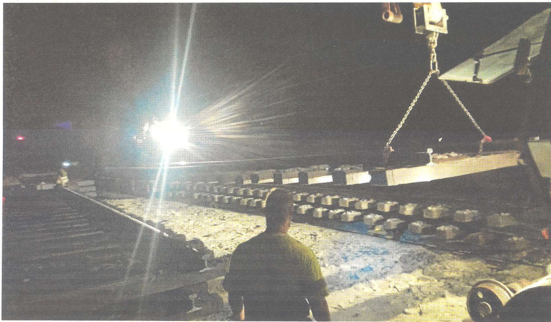
Obres a l'interior d'un túnel de la línia R15, aquest estiu. FOTO: ADIF
