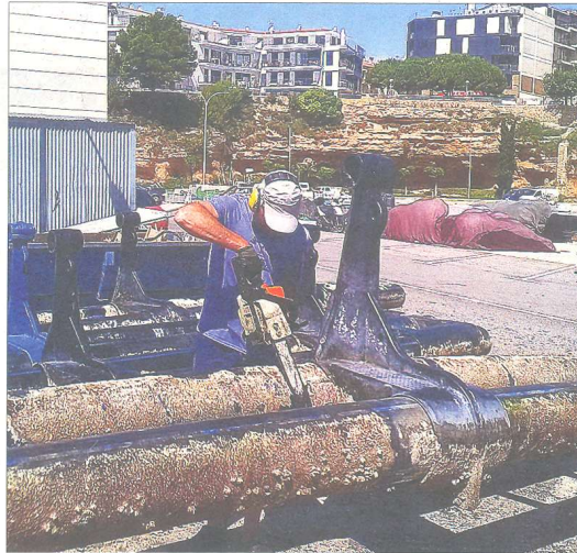
Un treballador del grup Invermar, treballant esta setmana al port de l'Ametlla de Mar en les tasques de desmantellament de les gàbies de l'antiga granja. / AGUSTÍ CRUELLES
