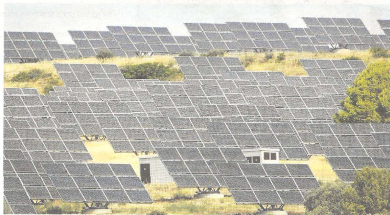
Imatge d'una instal·lació d'energia solar fotovoltaica a les Terres de l'Ebre. FOTO: JOAN REVILLAS
