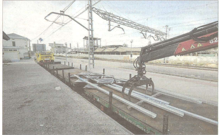
Nova senyalització vertical pendent de col·locar, ahir a l'estació ferroviària de Flix. FOTO: JOAN REVILLAS
