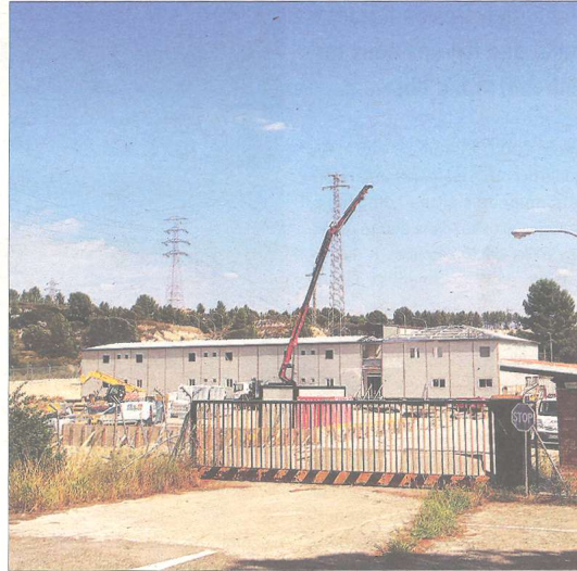
Estat de les obres de la caserna de la Guàrdia Civil, aquest dijous 31 d'agost.
