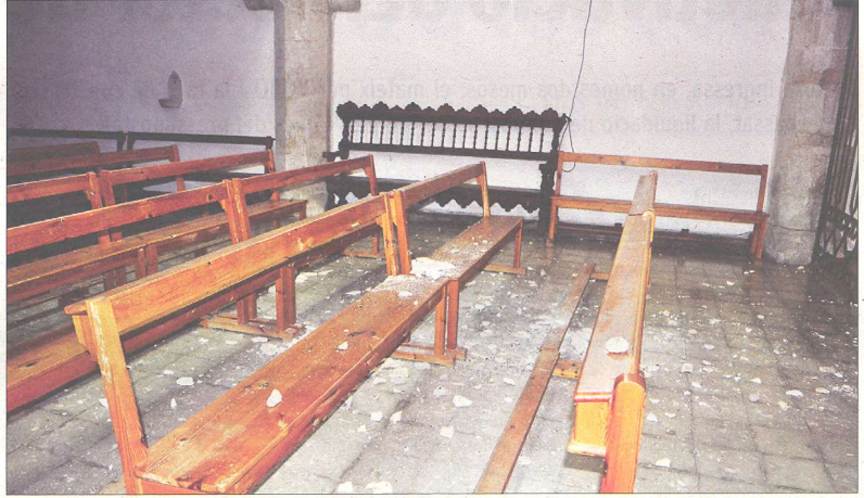
Imatge dels bancs de l'església del convent de Santa Clara plens de la runa caiguda del sostre. / NÚRIA CARO
