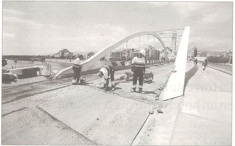
Obres al pont de l'Estat de Tortosa, aquest dilluns. FOTO: JOAN REVILLAS
