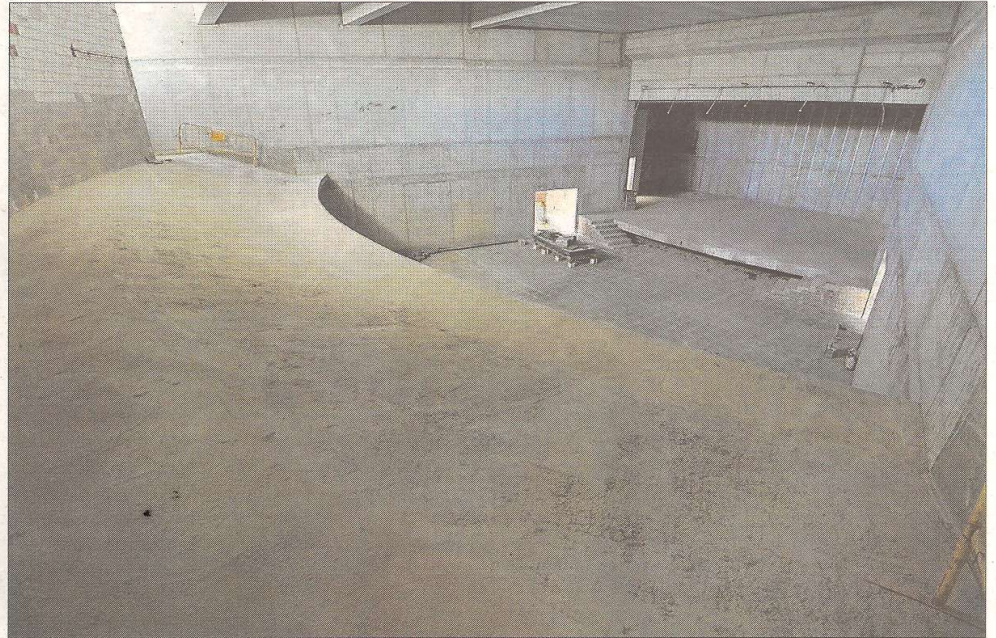
Imatge de l'estat actual de l'auditori en obres, aquest setmana. FOTO: JOAN REVILLAS
