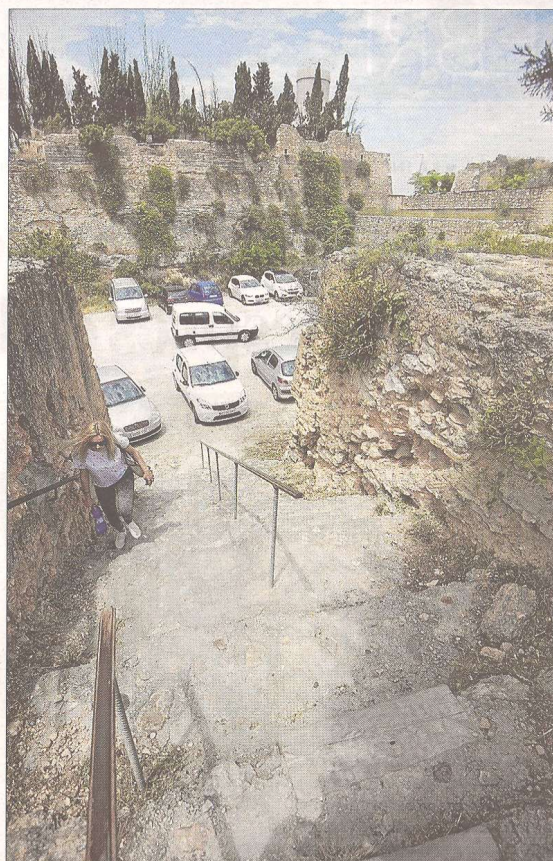
Estat actual de les escales que els usuaris fan servir per pujar des del fossat fins a l'hospital. FOTO: JOAN REVILLAS
