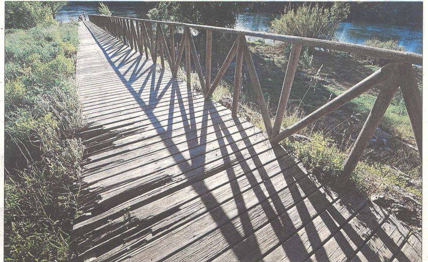
Imatge del mal estat d'una de les baranes d'accés al riu Ebre, al Passeig de Ribera, ahir. FOTO: JOAN REVILLAS
