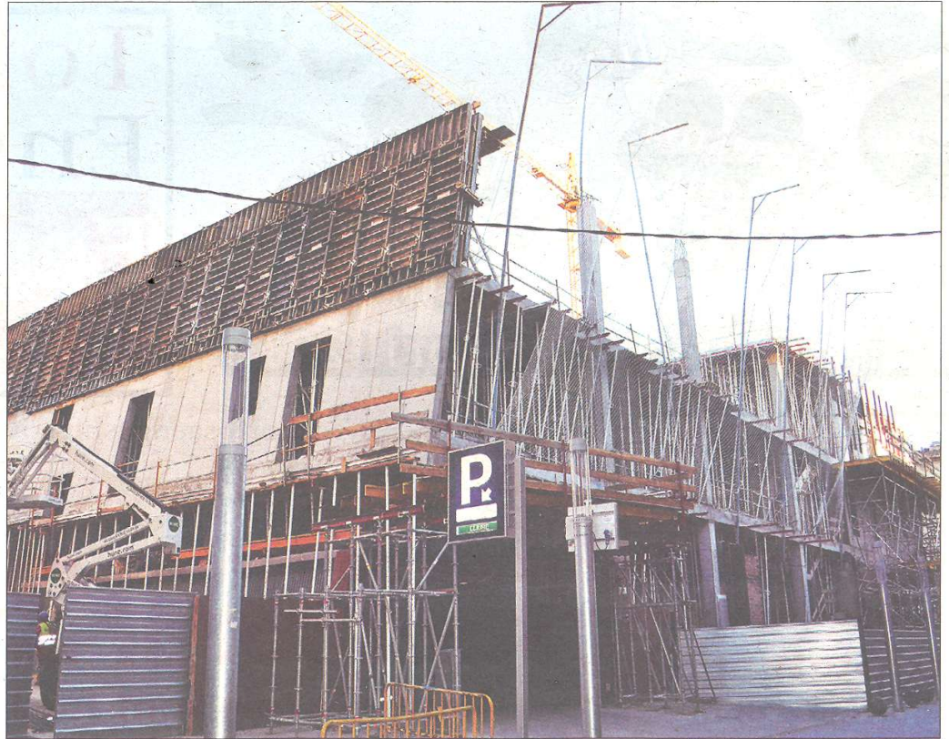
Imatge, presa aquesta setmana, de l'evolució de les obres de l'edifici. / NÚRIA CARO
