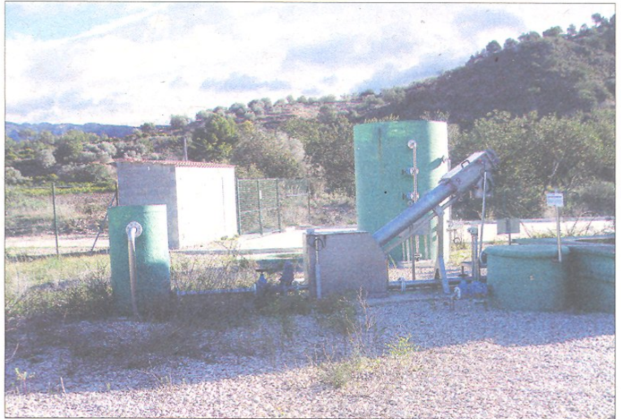
La depuradora de Tivenys és una de les que no estan acabades. / L'EBRE
