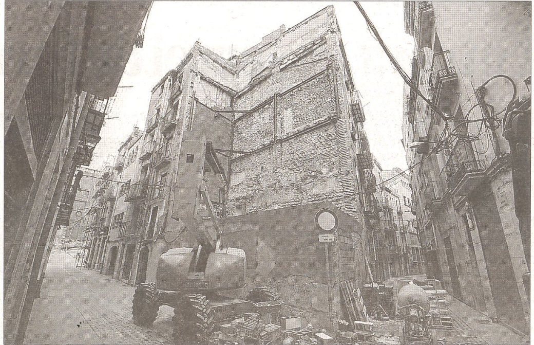
Obres d'enderroc d'un edifici i adequació del solar al carrer Montcada. FOTO: JOAN REVILLAS
