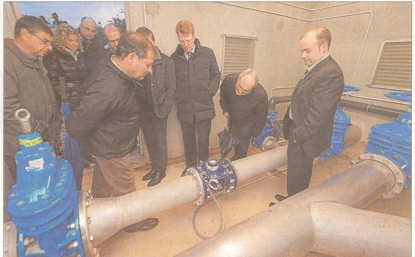
Les noves instal·lacions del pou a la partida de Sant Bernabé, a Jesús. FOTO: JOAN REVILLAS
