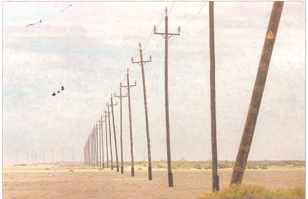
L'actual línia elèctrica aèria que creua l'istme del Trabucador, al marge dret del delta de l'Ebre. FOTO: JOAN REVILLAS
