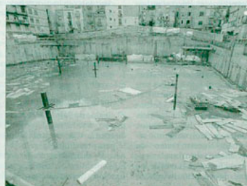
Les obres de l'edifici de les delegacions, cobertes d'aigua. FOTO: J. REVELLÀS
