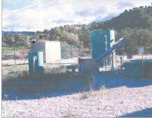
La depuradora de Tivenys en una imatge d'arxiu.
