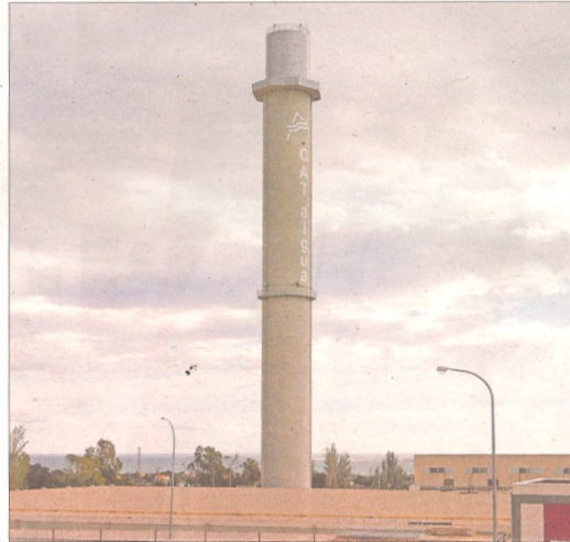
El CAT ha anunciat que preveu invertir 10 milions d'euros en reparar les canonades afectades per un procés de carbonatització.
