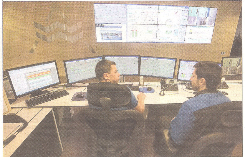
Sala de control de la planta del Consorci d'Aigües a l'Ampolla. FOTO: JOAN REVILLAS
