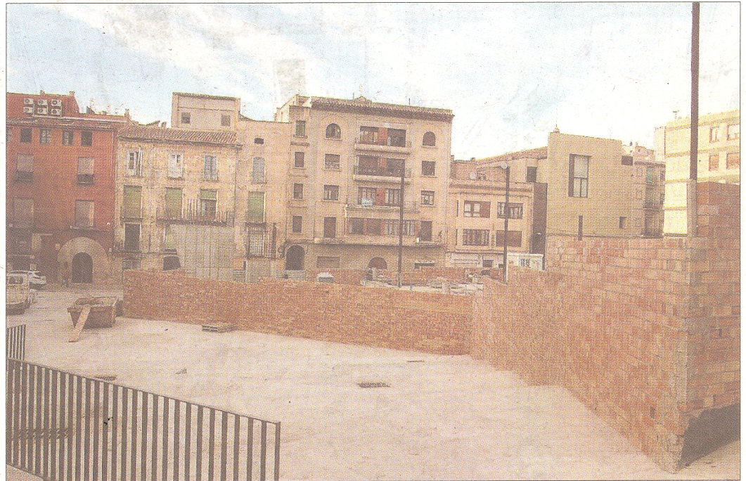
L'empresa adjudicatària de les obres ha reiniciat els treballs d'urbanització de la plaça, ahir. FÓTO: JOAN REVILLAS
