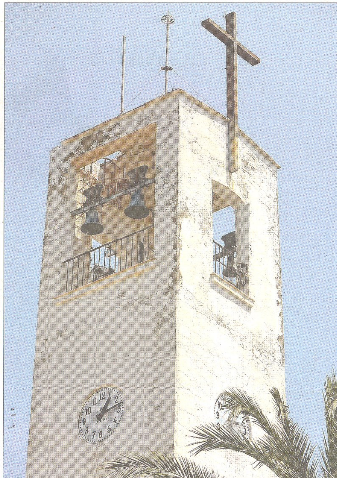
Aquest és l'estat actual del campanar. FOTO: JOAN REVILLAS
