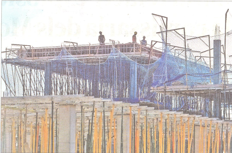
La nova escola de Sant Llàtzer, en construcció, ahir a Tortosa. FOTO: JOAN REVILLAS
