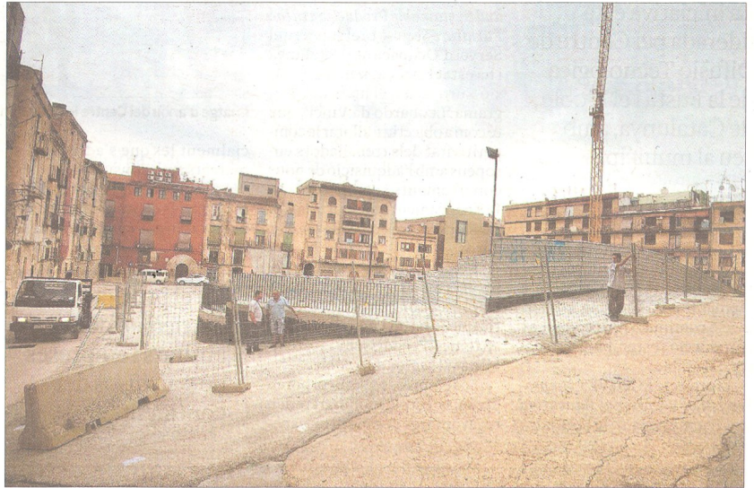
Imatge de l'estat del complex de l'edifici de les delegacions i l'aparcament soterrat. FOTO: JOAN REVILLAS
