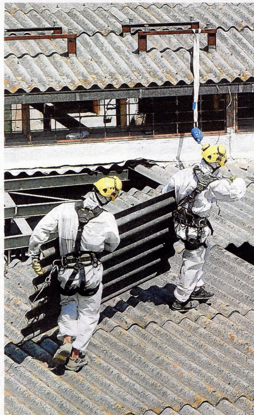
Uno de los tejados de amianto que se encuentran en la demarcación de Tarragona. FOTO: ALFREDO GONZÁLEZ
