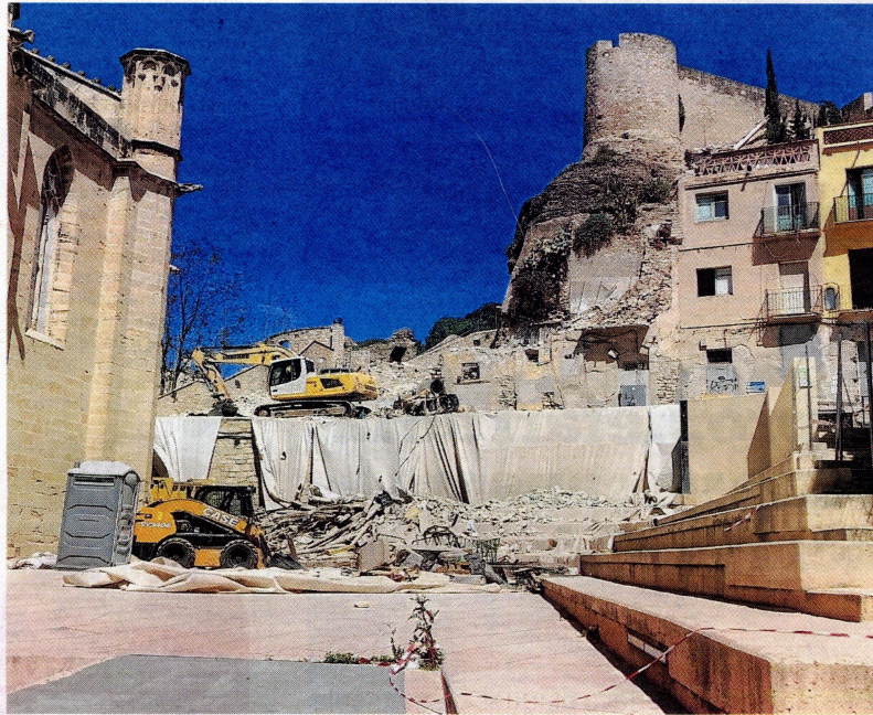
Estat actual de l'enderroc, decretat per urgència arran de l'estat de ruïna dels edificis. FOTO: M. MILLAN
