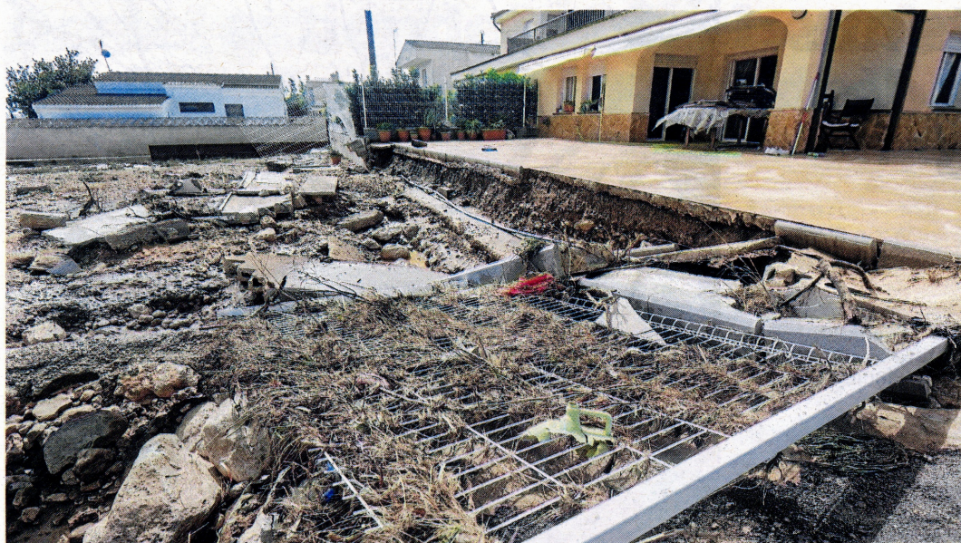
Danys al terme d'Alcanar a causa dels aiguats del passat 3 de setembre. FOTO: JOAN REVILLAS
