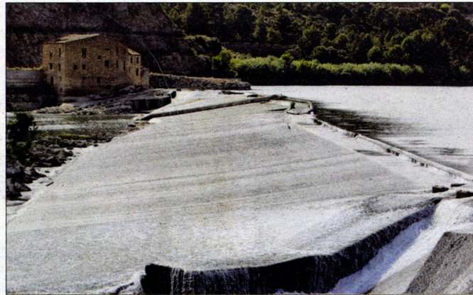
L'Assut de Xerta té una triple funció: origen dels canals de regadiu, resclosa per a la navegació i base d'una minicentral hidroelèctrica.
