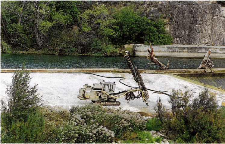
Treballs en execució a l'assut del riu Ebre entre Xerta i Tivenys. FOTO: JOAN REVILLAS
