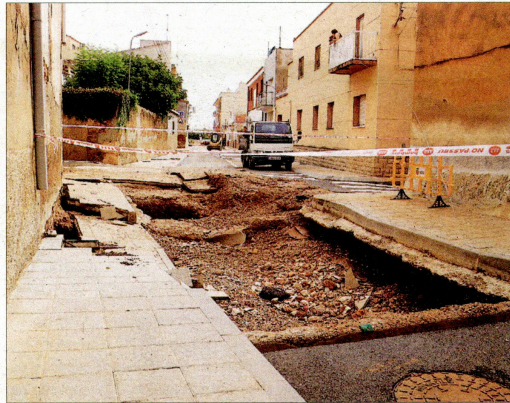
Esvoranc al carrer Aire que canalitza el barranc del Pelós. / ACN
