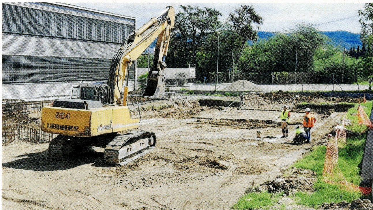
Obres en marxa de l'ampliació del CAP de Roquetes, aquesta setmana. FOTO: JOAN REVILLAS
