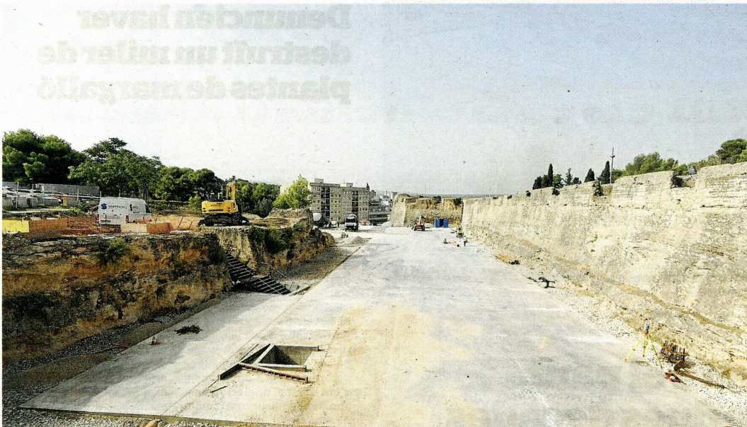
Els fonaments de formigó al fossat estan finalitzant i ara s'instal·larà l'estructura del pàrquing provisional. FOTO: JOAN REVILLAS
