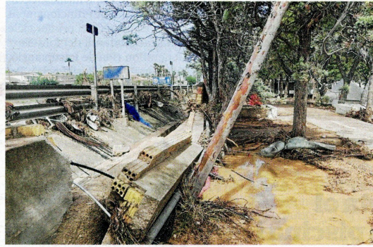
Danys en el mur del càmping Alfacs, a la zona d'Alcanar Platja.
